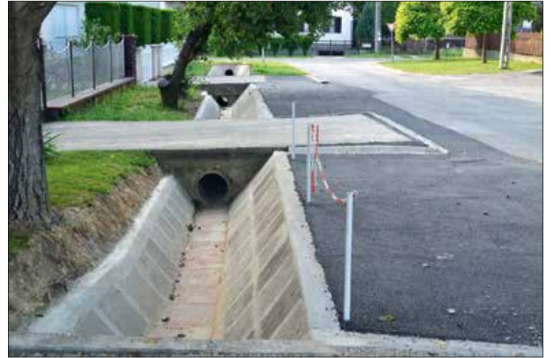
Sok lakó gondját orvosolja a vízvezető.
